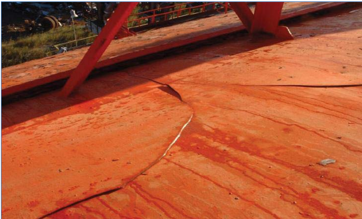
Abbildung 35 Kaltriss der Decksplatte. Quelle: DNV GL.
