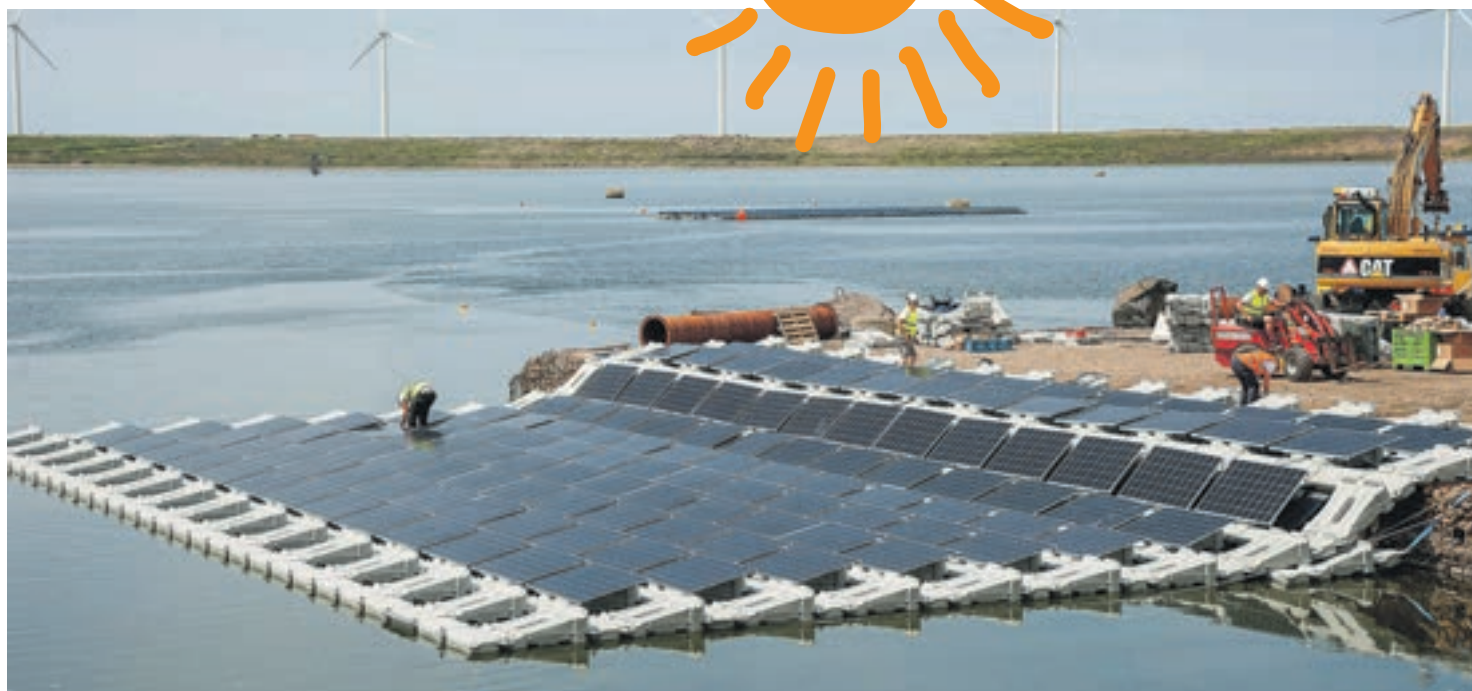
Bij de Slufter wordt geëxperimenteerd met drie verschillende drijvende installaties met elk zo'n 160 zonnepanelen
