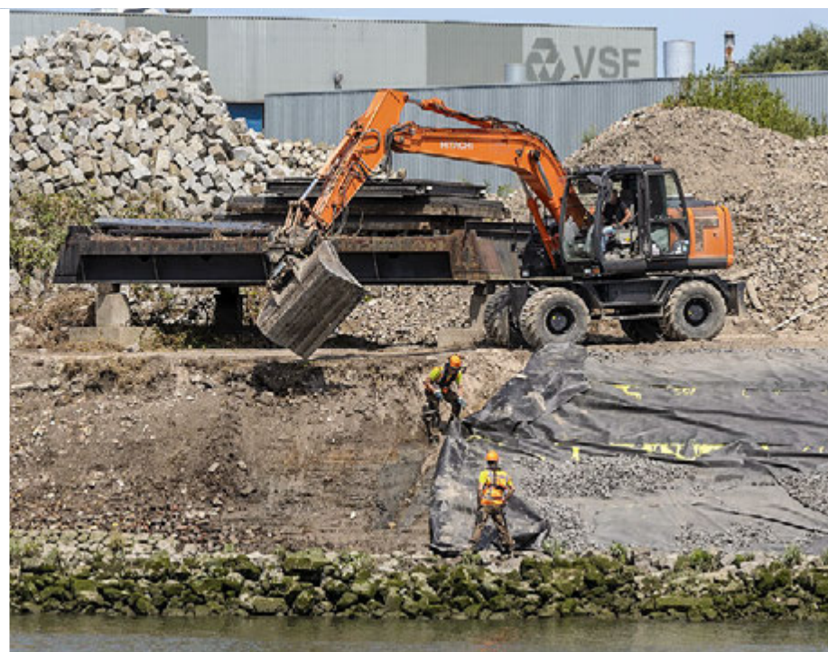
Geen halve maatregelen: om de terugkeer van de Japanse duizendknoop te voorkomen, worden afgegraven locaties afgedekt met doek.
