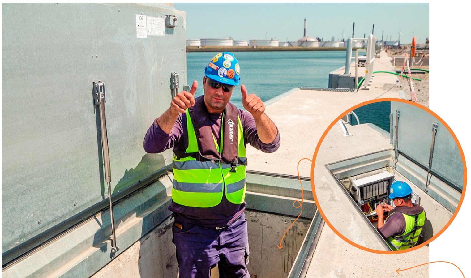
Bij de HES Hartel Tank Terminal is 2 kilometer kade beschermd tegen roestwerking met zogenoemde opgedrukte stroom.
